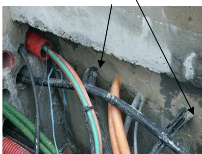
BOUCHEMENT des TREMIES avec UN PAREMENT REFRACTAIRE de 3 cm REVETU ensuite de 28 mm de FIRE BARRIER 135
