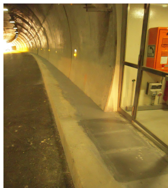
Chambre de tirage en arase
