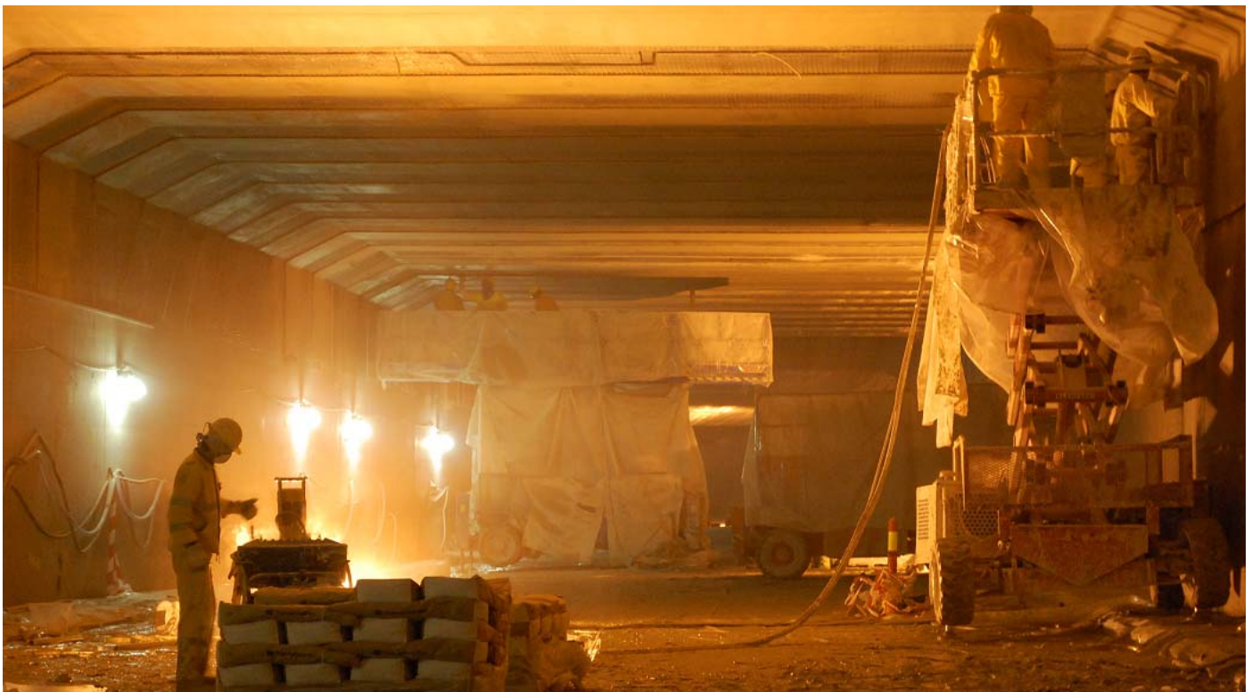
TUNNEL IMMERGE de BJORVIKA – PROTECTION AU FEU avec le FIRE BARRIER 135
